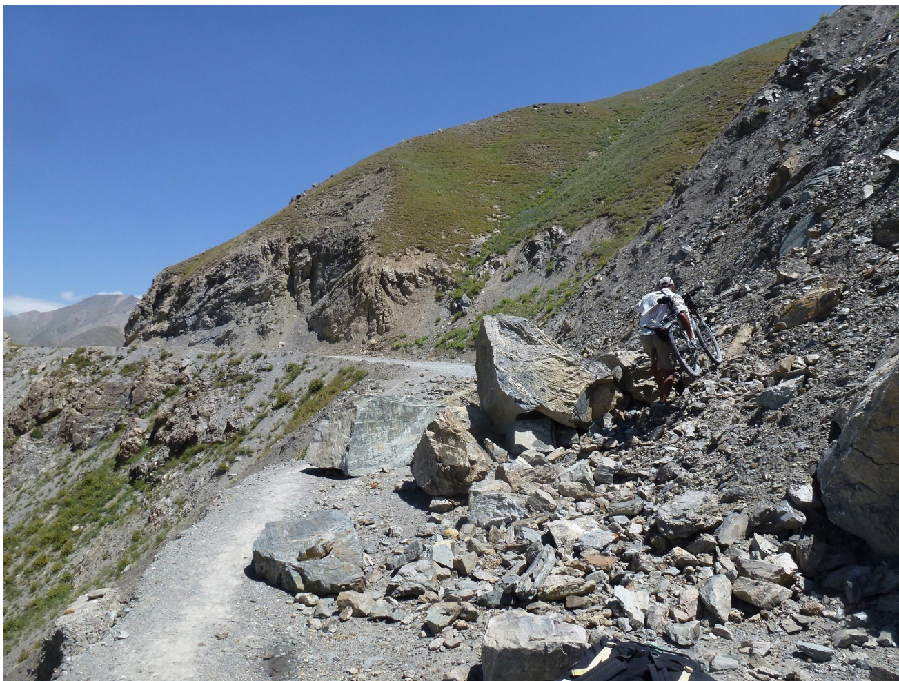
Во многих местах дорога разрушена
