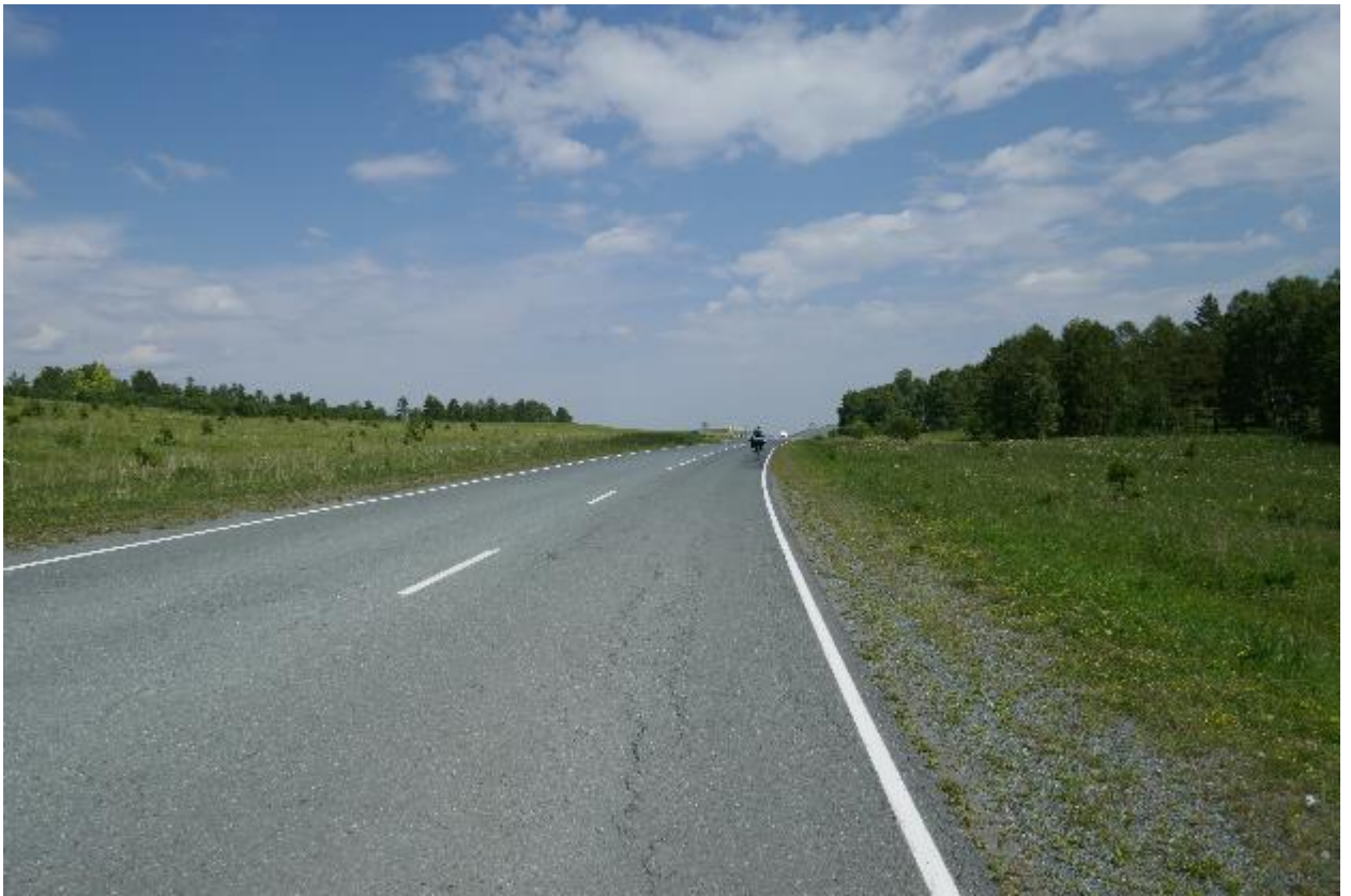
Рисунок 2.46. Качество дороги на вершине ПП7.
